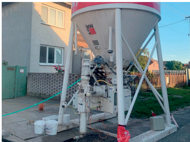
Kompletná strojná zostava – transportné silo + silová miešacia stanica SMP
