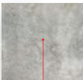
ZNEČISTENÁ FASÁDA BEZ TRHLÍN
