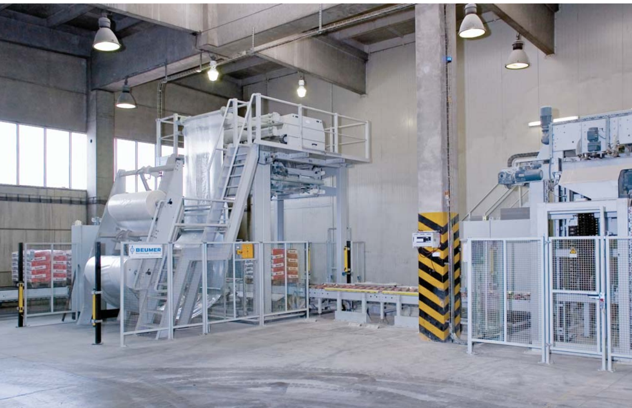
Pohľad na paletovaciú a baliaciu linku vo výrobnom závode Rohožník.
